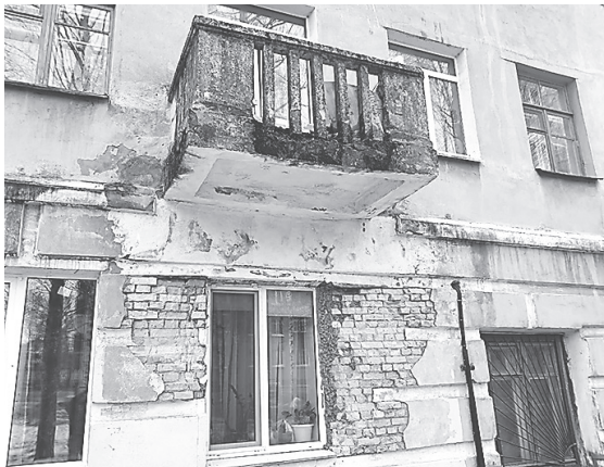
Сертолово (микрорайон Черная Речка). До ремонта...
