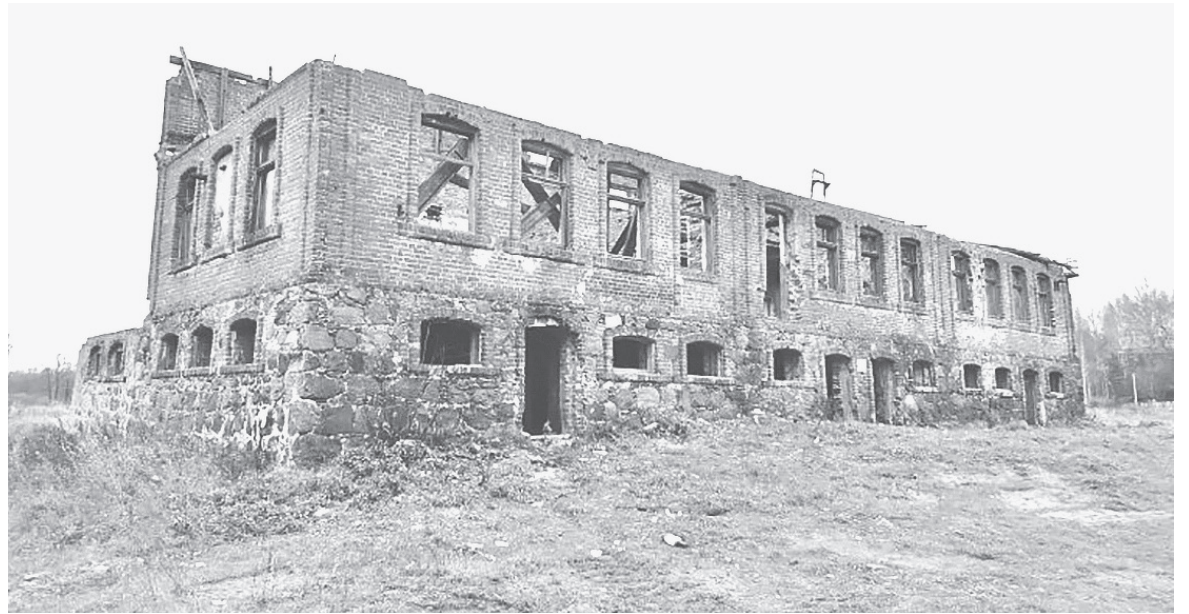
Разрушающееся здание судоремонтных мастерских пароходной компании бр. Плетцер на Преображенской пристани (Толмачево)
