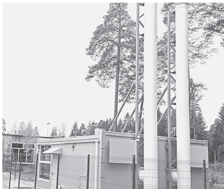
■ Новая блок-модульная котельная
